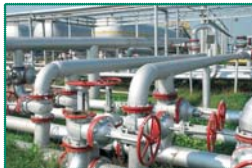
Regulatory tap valves at a oil-pumping station/ Регулирующие краны на станции перекачки нефти
