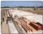
Construction site of the Ice Center Arena in Sochi. Строительная площадка Центра ледового спорта в Сочи
