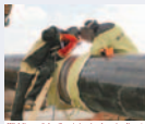
Welding of the first joint in the pipeline/ Сварка первого шва нефтепровода
